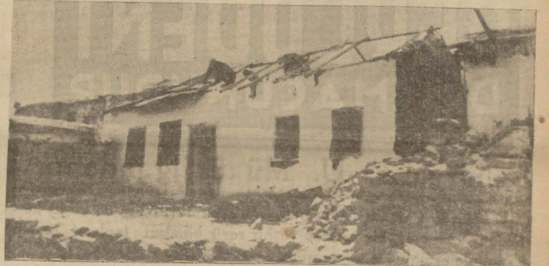
Dağ mahallesinin çalışkan halkı evlerinin fırtınadan kopan çinko çatılarını ertesi sabah tekrar yapıyorlar
